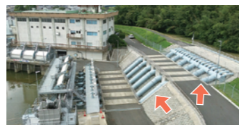
法川排水機場に増設された可搬式排水ポンプ
